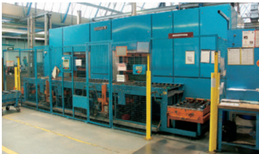
▲ Die moderne Doppelkammer-Anlage zur Reinigung der Filtergehäuse
